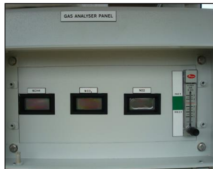
Landfill Gas Analyser panel
